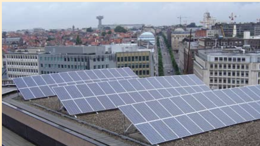
De grootste fotovoltaïsche installatie in Brussel staat voortaan op het dak van de maatschappelijke zetel van de Raad van de Europese Unie: 227 m 2 panelen.
