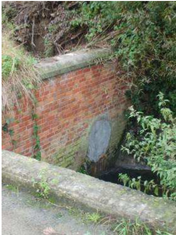
Het recent dichtgemetselde lozingspunt van de Kouterstraat in Tildonk. Het water gaat nu in plaats van naar de beek, naar het waterzuiveringsstation van Boortmeerbeek.
