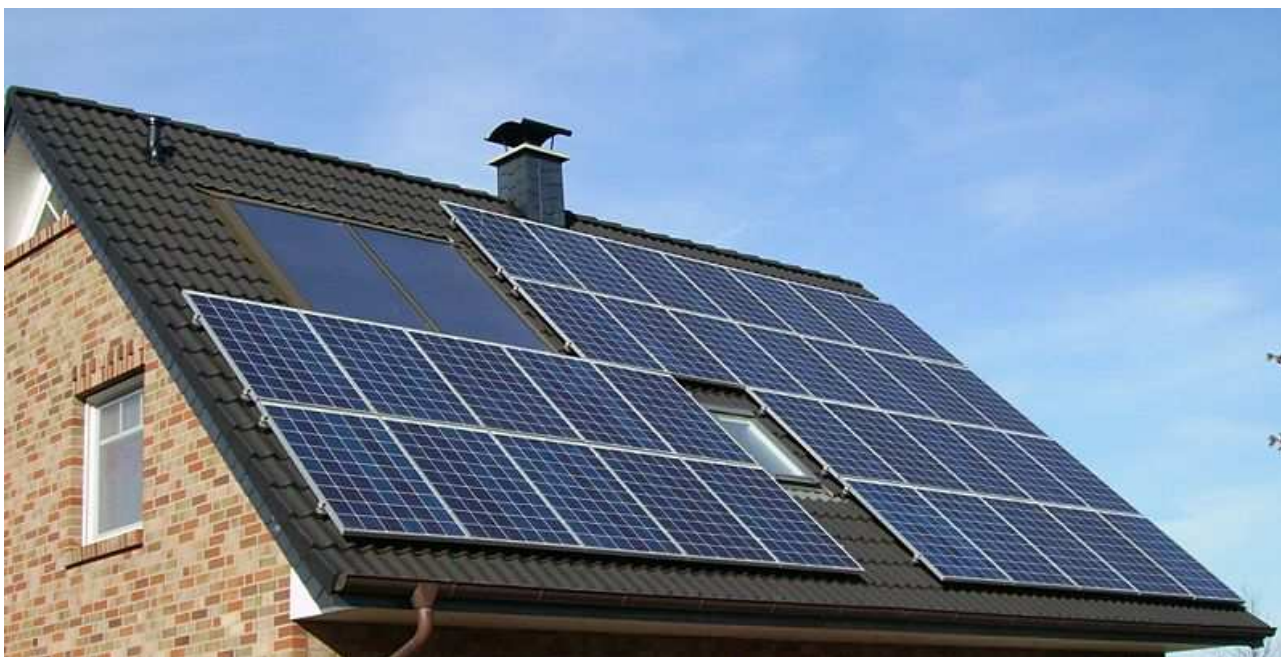
Een dak met foto-voltaïsche zonnepanelen én een zonneboiler
