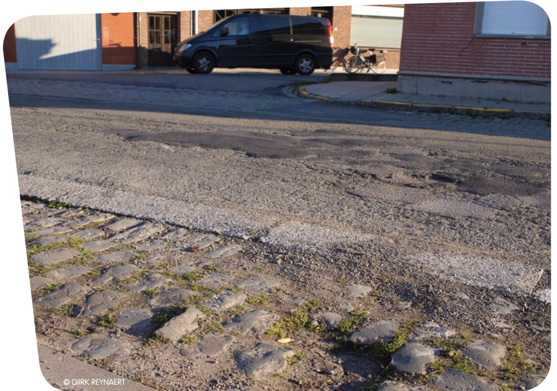
Het gehavende wegdek in de Kijkuit- en Marktstraat
