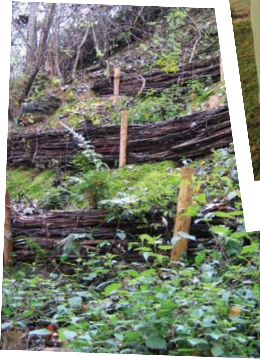
Erosiedammetjes in de holle weg Flosstraat in Vossem
