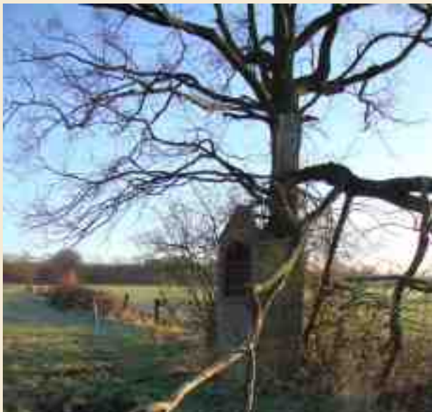
Een veldkapel die dringend aan herstel toe is.
