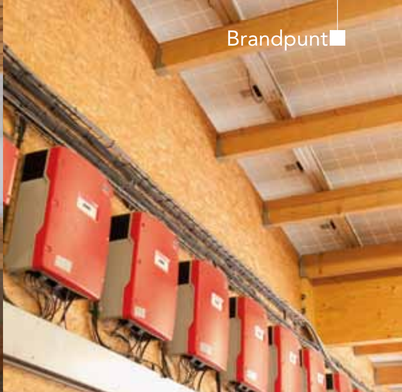
De zelfdragende fotovoltaïsche zonnepanelen.
