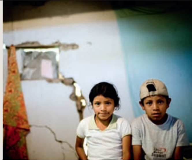
Door explosies in de San Marcosmijn in Guatemala ontstaan enorme barsten in de muren, zoals in het huis van deze twee kinderen. FOTO STEVEN HEYVAERT
